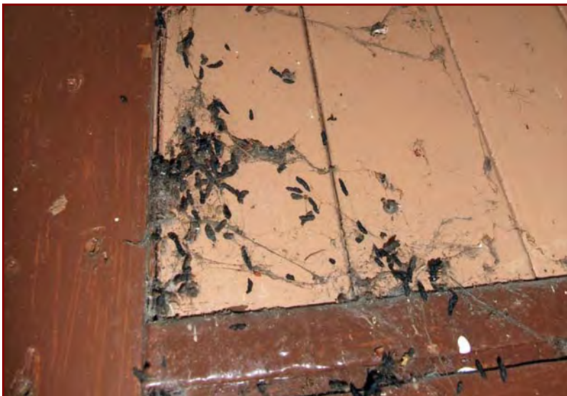
Schwielowseestr. 70: Kot einer mittelgroßen Fledermausart hinter einem Fensterläden belegt die Nutzung als Tagesquartier.
